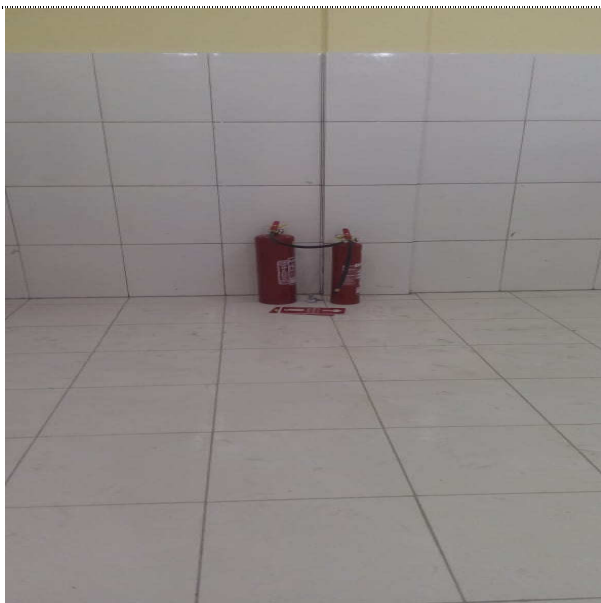
Dispositivos de combate a incêndio
