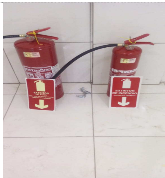
Dispositivos de combate a incêndio
