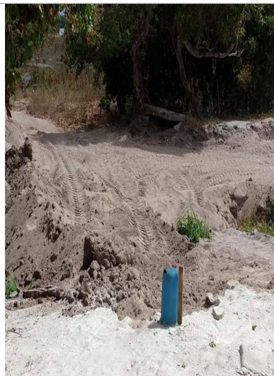
CAPTACÃO- poços perfurados
